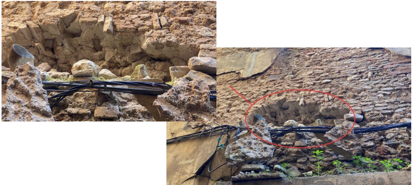
Figure III. 8: Mur en maçonnerie de moellons présentant une cavité révélant la structure interne. [48]
