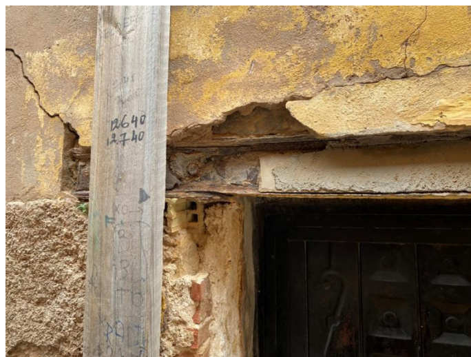
Figure III.35: Porte surmontée d'un linteau métallique présentant des traces de corrosion. [48]
