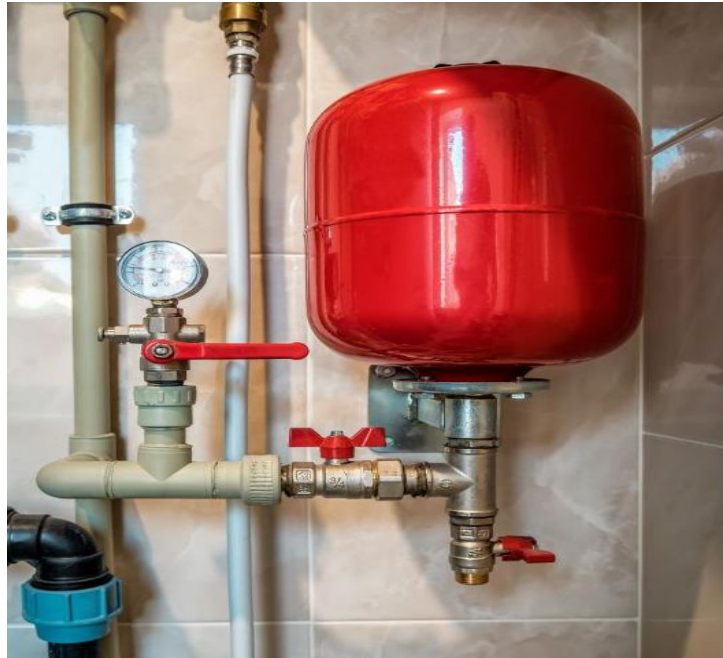
Figure II.13: Le vase d'expansion dans une installation solaire à thermosiphon
