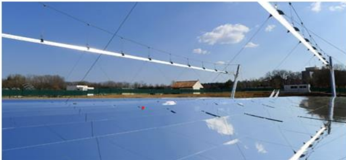
Figure I.9: Centrale solaire thermodynamique à miroirs de Fresnel
