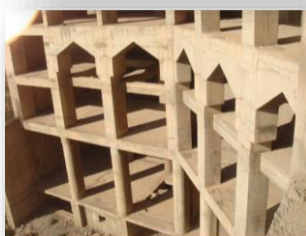
Poteau et poutres Fissures verticales et diagonales
