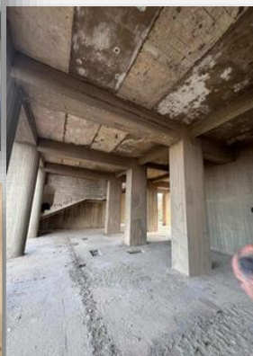
Traces d'humidité, Fissuration en toile d'araignée
