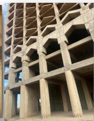
Légères fissures à la base des poteaux
