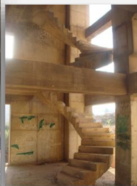
Escaliers: Béton friable, nez de marche cassés
