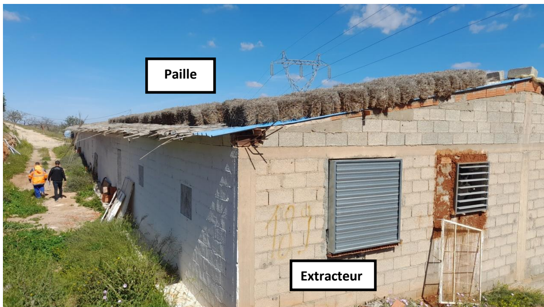
Figure 40: Présence de balles de paille sur le plafond pour l'isolation thermique par contre pour les murs pas d'isolation : Une seule paroi et manque d'ombrage (Photo Originale).
