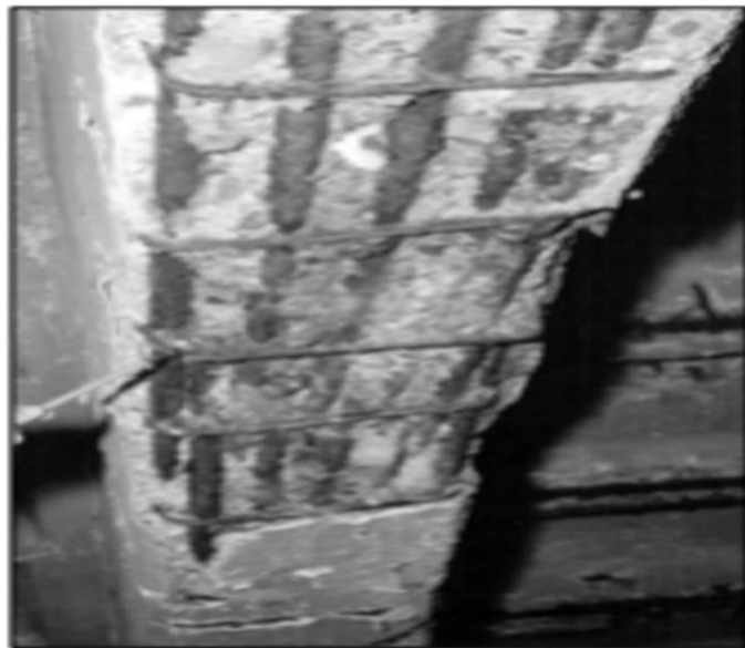
Figure 1.6 : Poutre en béton armé : corrosion avancée des armatures en acier, réduction du diamètre et rupture des étriers, dans certaines zones, dues à la corrosion par les ions chlorure(Pepenar, 2015)
