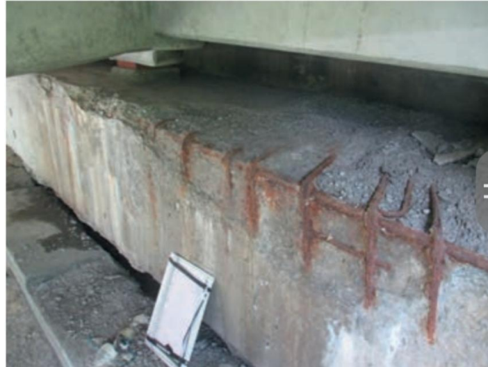
Figure 1.7 : Éclatement de béton du chevetre (BRAZILLIER et al., 2023).
