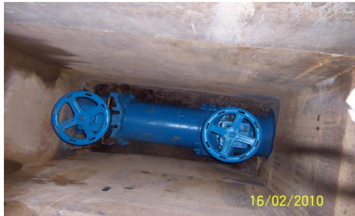
Photo 7 : Vannes plane de type Wey (DN 400)
