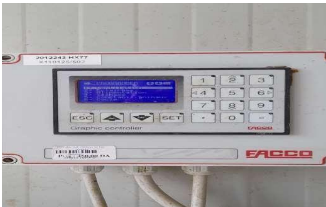
Figure I-4 Système de contrôle automatisé
