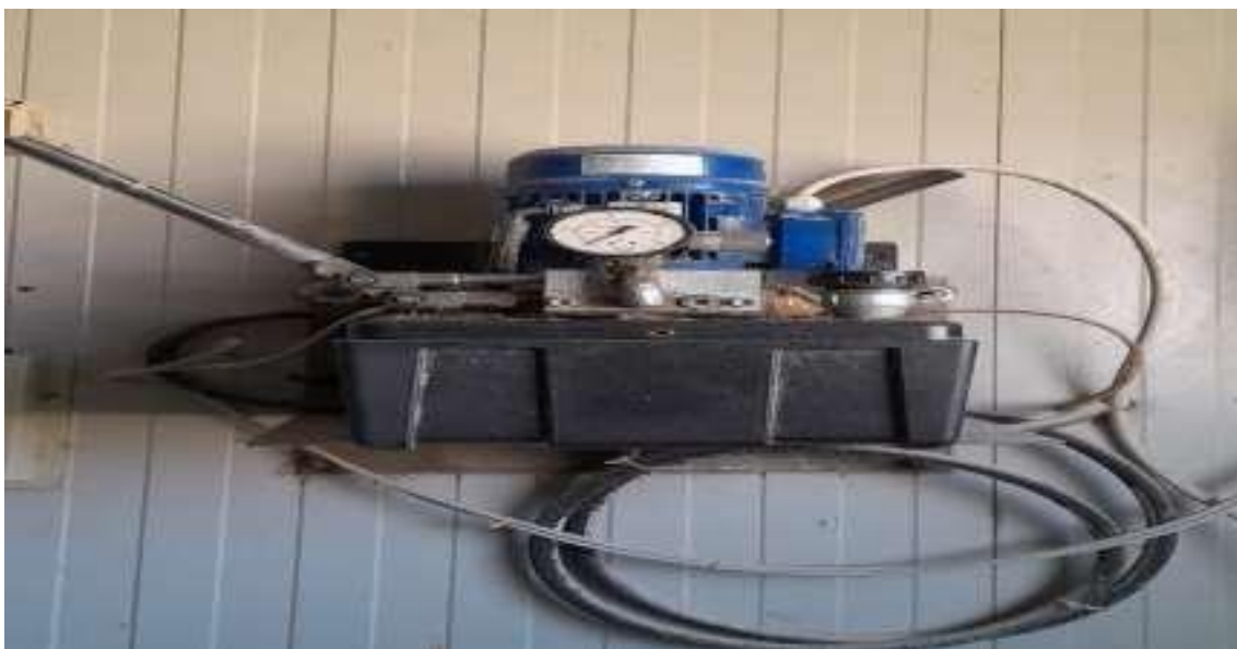
Figure I-8 Moteur de commande d'ouverture et fermeture des fenêtres
