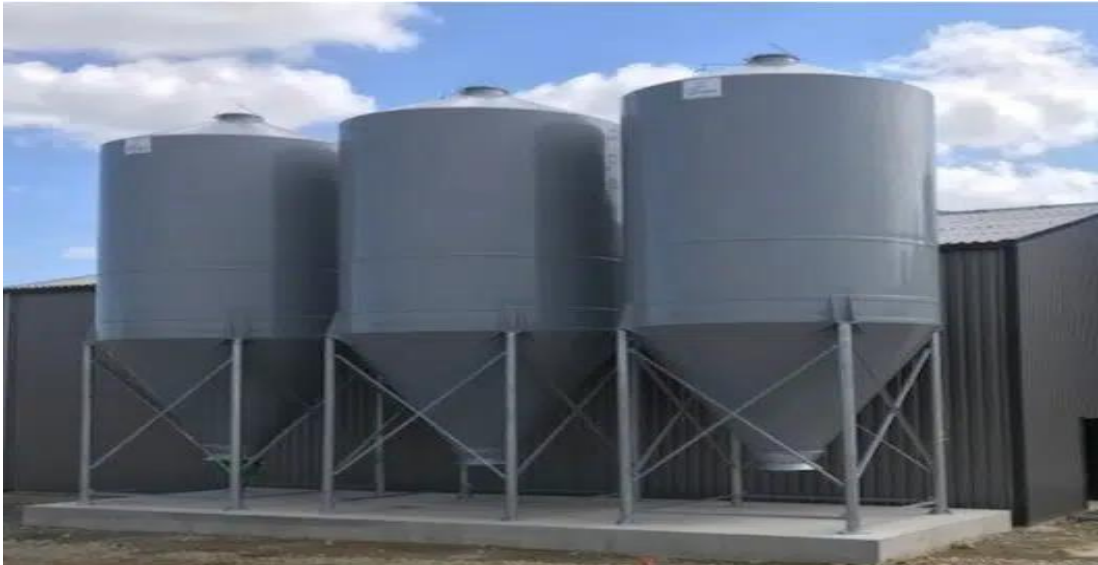
Figure II-31 Silos de stockage des produits fini
