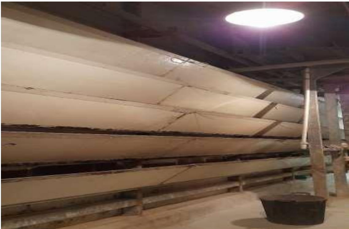
Figure I-7 Panneau pad cooling à l'intérieur
