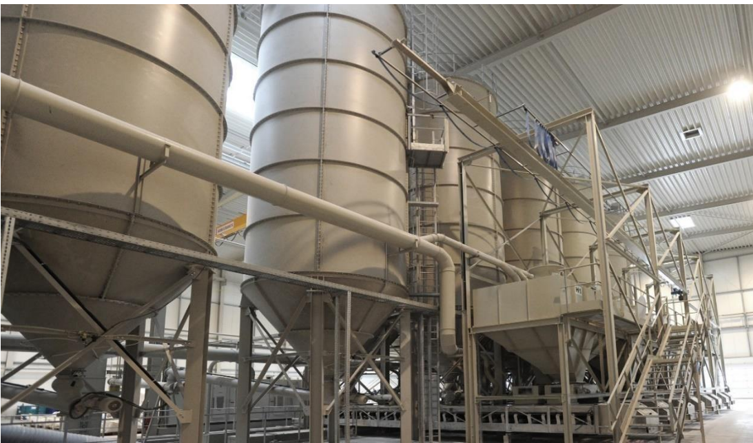
Figure II-30 Petits Silos verticaux au milieu de ligne
