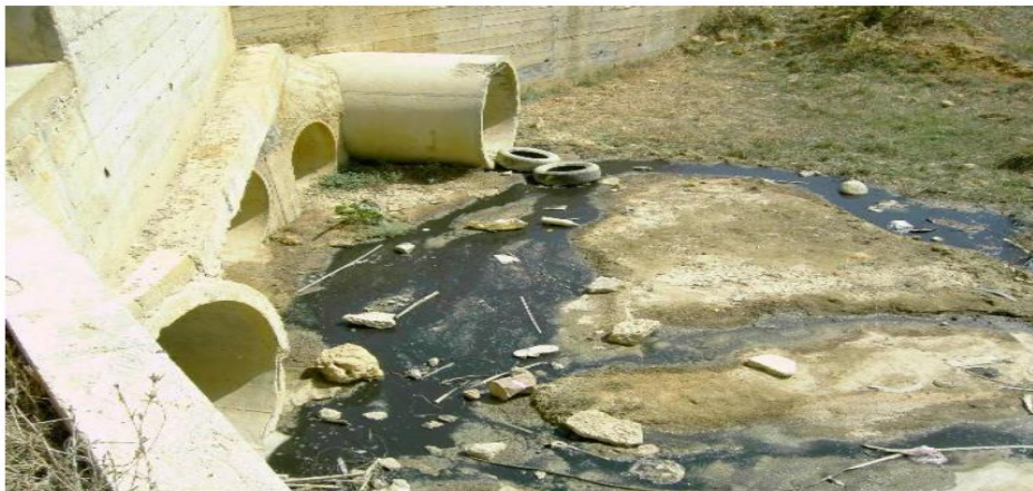
Figure 19 Canal d'évacuation de lixiviat vers l'oued ben Brahim (CET Ouled Fayet) Alger.
