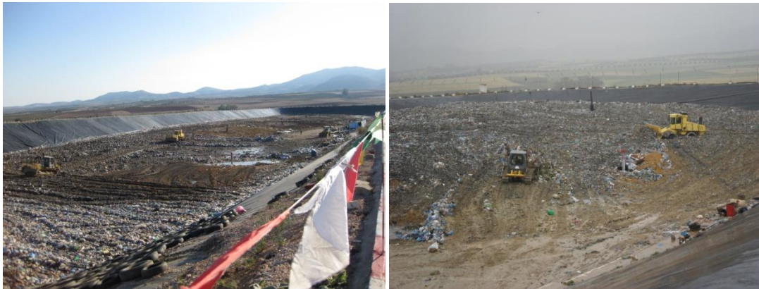
Figure 11 Casier durant exploitation
