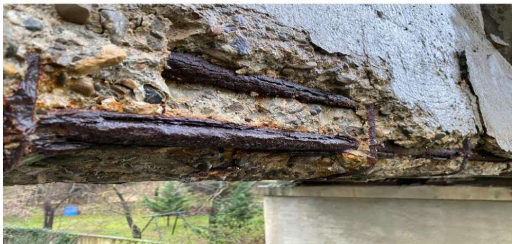
Figure 1.2: Les conséquences de la corrosion sur un ouvrage non protégé [2]
