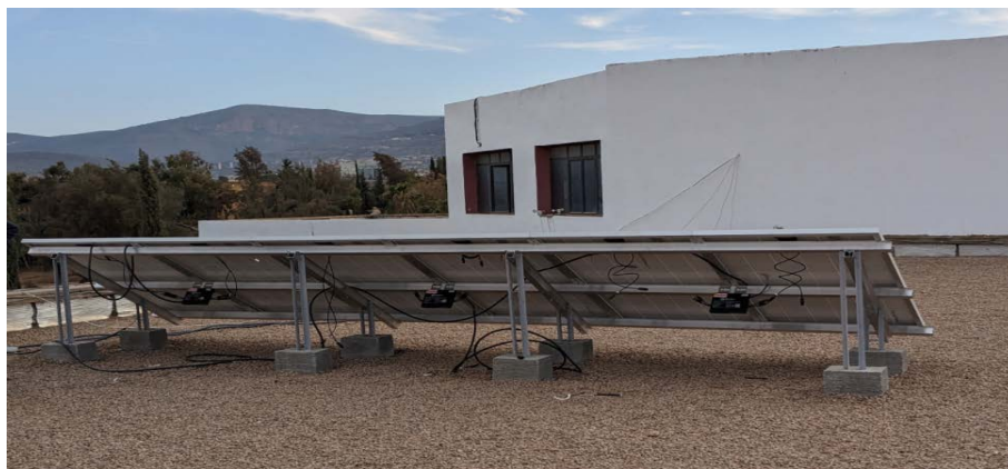
FIGURE II.3 – Panneaux photovoltaïques + micro onduleur
