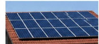
1. PANNEAUX SOLAIRES PHOTOVOLTAÏQUES
