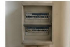
4. TABLEAU ÉLECTRIQUE AC
