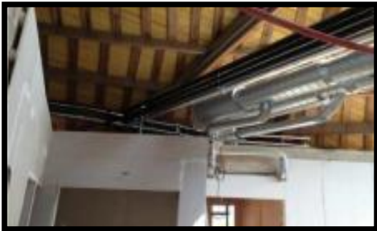
Photo 33:Un système de ventilation à double flux avec récupérateur d'énergie.
