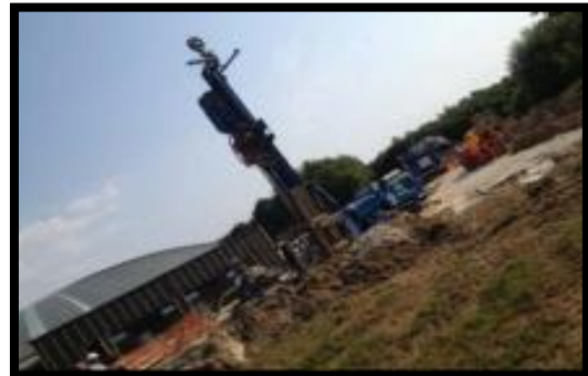
Photo 30:Une installation d'une pompe à chaleur réversible eau-eau par capteur pour la géothermie
