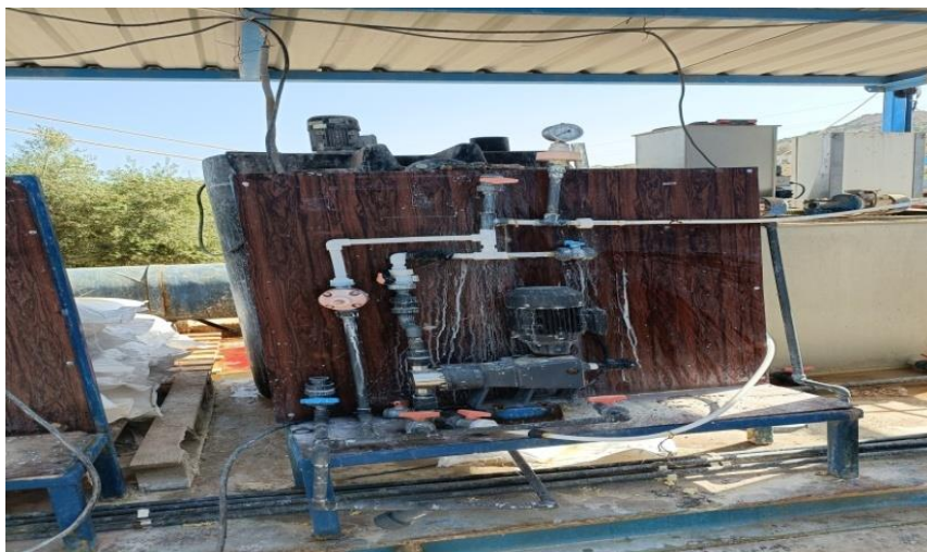
Photo 4: L'injection de coagulant sulfate d'alumine (Tlemcen le 09-04-2025)
