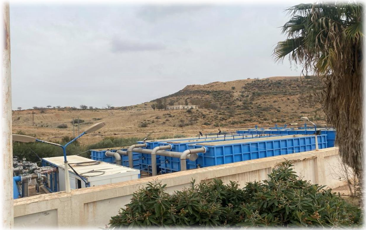
Photo 2: Système monobloc au niveau de la station
