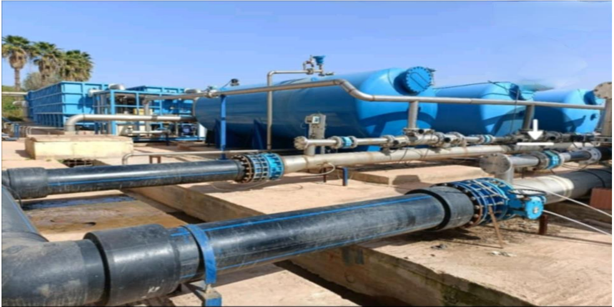
Photo 7: Trois filtres de filtration d'une seule filière
