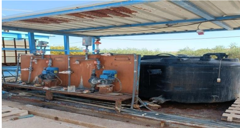
Photo 3: L'injection de l'hypochlorite de sodium NaClO (Tlemcen le 09-04-2025)
