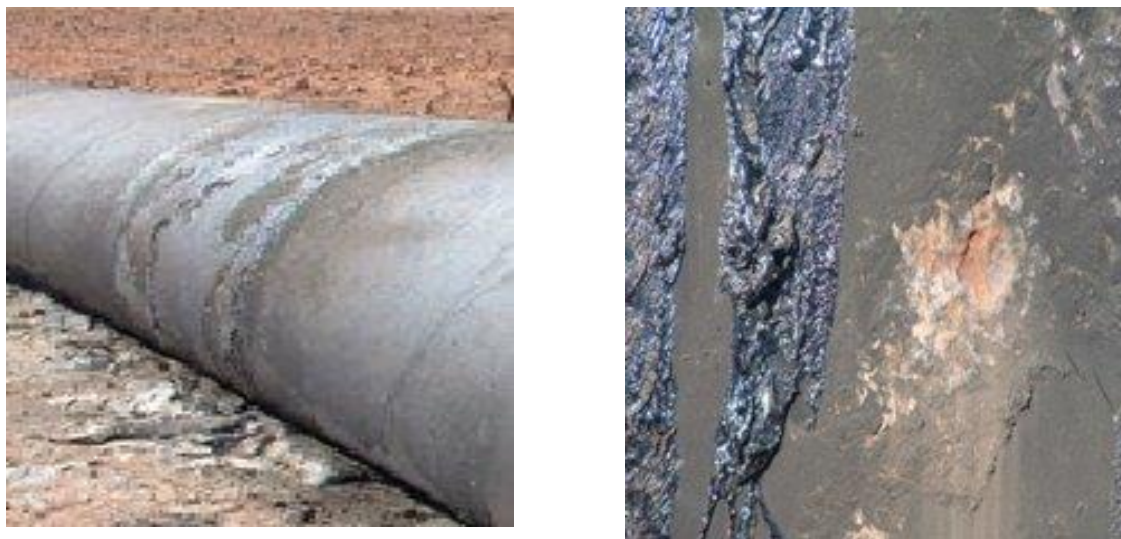
Figure 16 : Exemples de défauts de surface externes sur la ligne GZ1 40''
