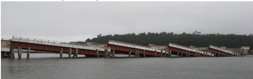
Figure I-2 Délogement des travées du pont de showa suite au séisme Niigata [2]
