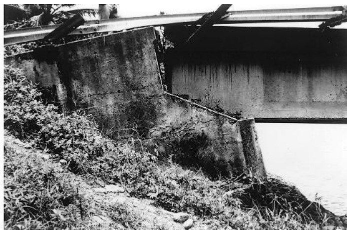
Figure I- 7 Rotation de la culée due à la liquéfaction du sol au Costa Rica [2]
