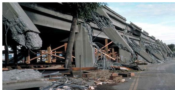
Figure I-5 Effondrement du premier niveau de Cypress street sur le pont inférieur suite au séisme de loma prieta [2]
