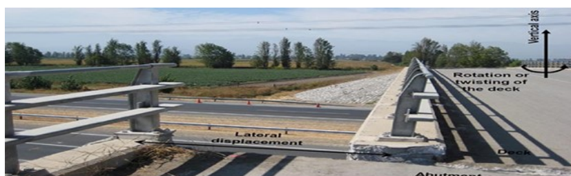
Figure I-3 Viaduc ayant subi d'importants déplacements
