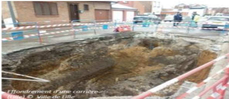
Figure 1. 6 : Effondrement de chaussée à Lille : Impact d'une ancienne carrière souterraine [6]
