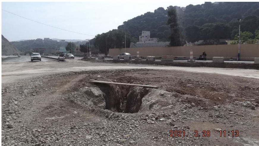
Cavité au niveau du giratoire 2
