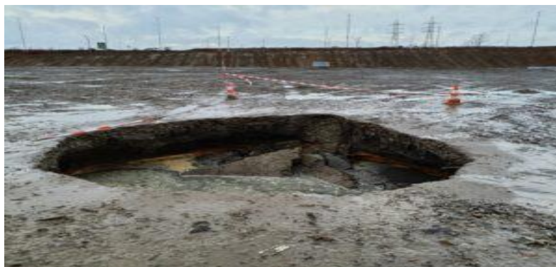
Figure 1. 7 : Cratère sur un chantier à Vottem (Liège) effondrement du sous-sol [6]
