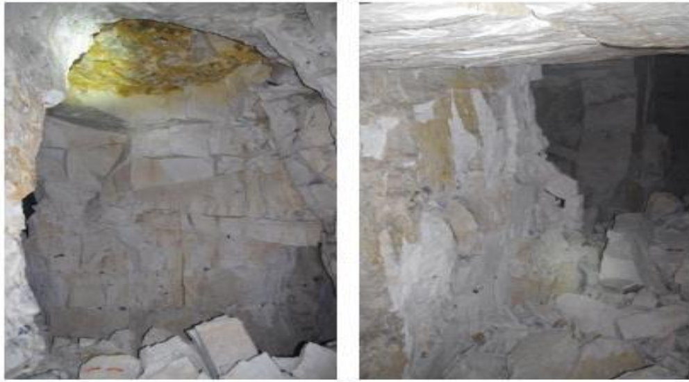
Figure 1. 5 : Dégradations observées dans une carrière souterraine [5]
