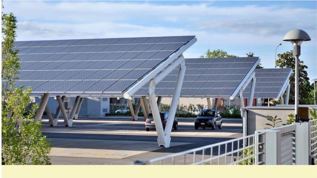
Figure 91 : Panneaux solaires pour ombrager les espaces de stationnement, Source : (Brentley, 2023)
