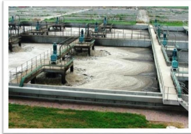
Fig. II.4 : Bassin d'aération (Toubal, M.,2024)
