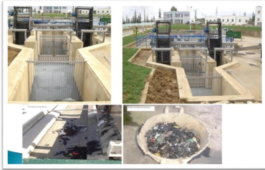
Fig. II.1 : Dégrilleur (Toubal, M.,2024)
