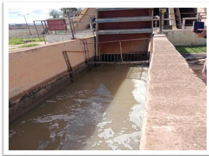
Photo. IV.2: Grille grossière manuelle (01 unité).
