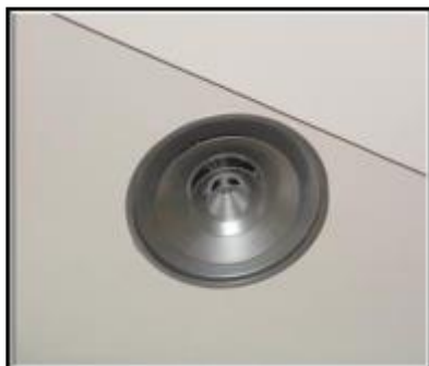
Figure 66 : bouche de soufflage
