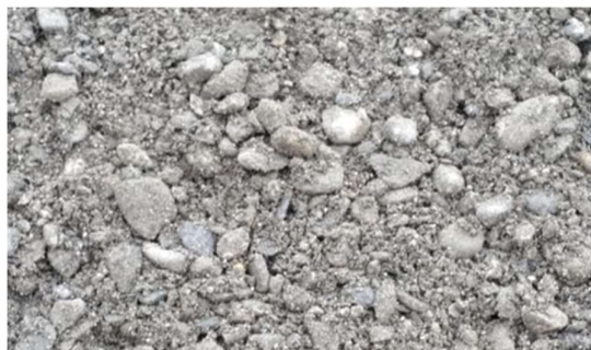
Figure II. 25 : Texture macroscopique d'un béton à granulats ordinaires (BGO) montrant la compacité de la matrice cimentaire. . [58]
