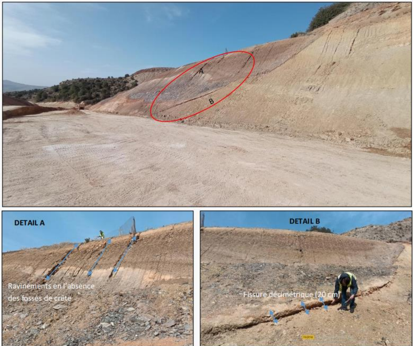
Figure 3.7 : Photo sur terrain de l'apparition des fissures sur le talus (SET Sétif, 2022)
