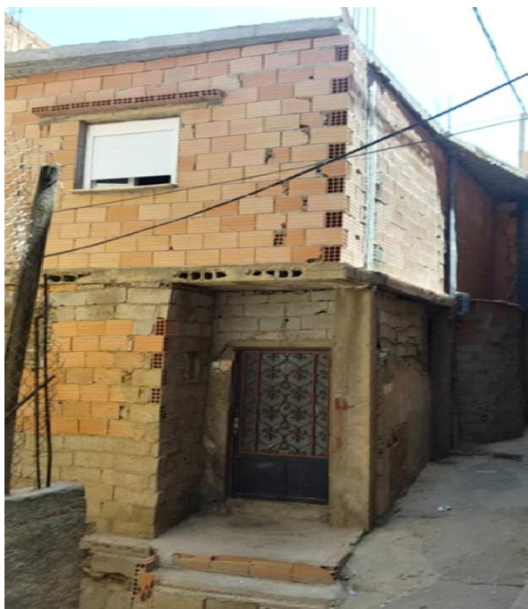
Figure 18: Habitations vétustes dans une voie complètement piétonne.
