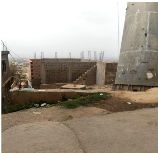
Figure 35: Construction inachevée en R+1.
