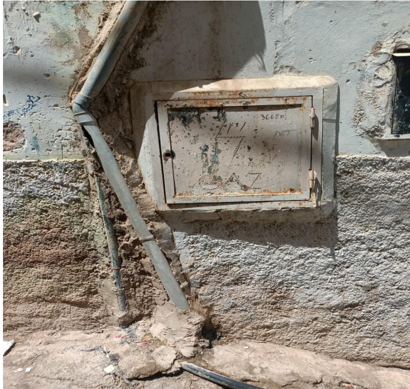
Figure 45: Coffret pour compteur individuel de gaz.
