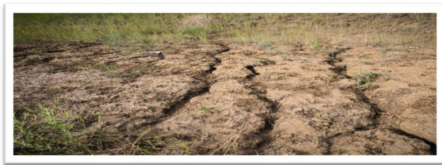
Photo 1.2.5) Le problème de l'érosion [5]
