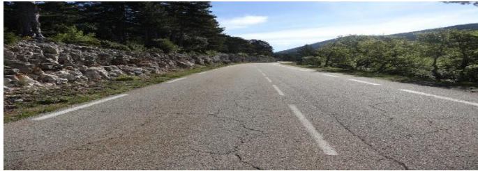
Photo 1.2.3) Les fissurations dans les terrassements [3]
