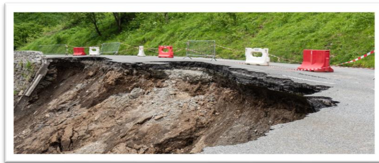
Photo 1.2.4) Affaissements des terrassements [4]
