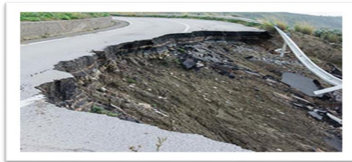
Photo 1.2.1.1) glissements de terrain
