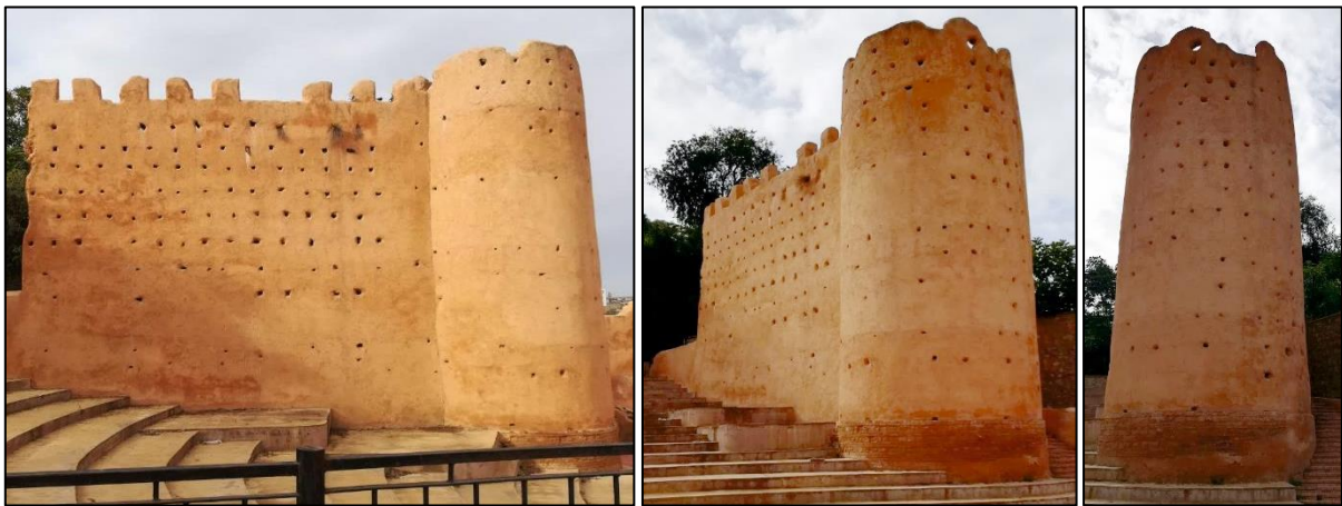
Photo 45. Vues sur le fragment BQ 2. Source Auteur du mémoire Avril 2018
