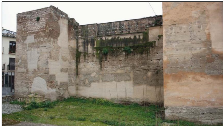
Photo 14. Etat de la porte du côté Ouest après l'intervention. Source Antonio ALMAGRO 214
