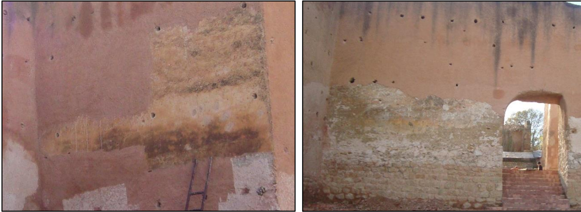
Photo 154. Différences de tons entre l'origine et le nouveau. Source auteur du mémoire Octobre 2010
