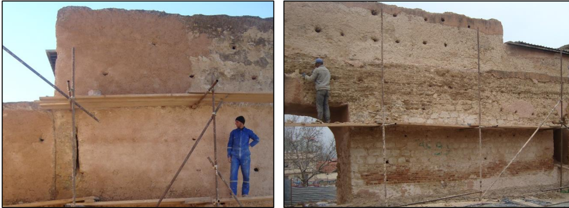
Photo 156. Départ de fracture verticale (à gauche), et matériaux de restitution de volume (à droite). Source auteur du mémoire Janvier 2011
