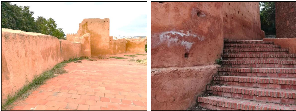
Photo 158. Humidité, efflorescence, et végétation après l'intervention de 2010. Source auteur du mémoire Octobre 2018
