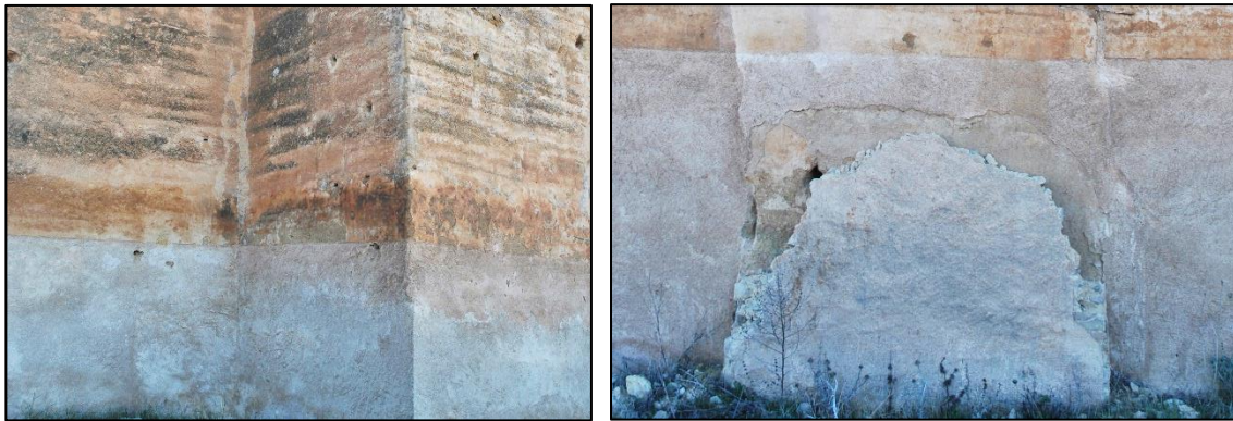
Photo 174. Effets du manque de respirabilité de la nouvelle couche. Source auteur du mémoire Avril 2018
