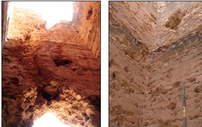
Photo 10. Détérioration des parements internes de la tour avant l'intervention. Source MILETO & VEGAS 209
