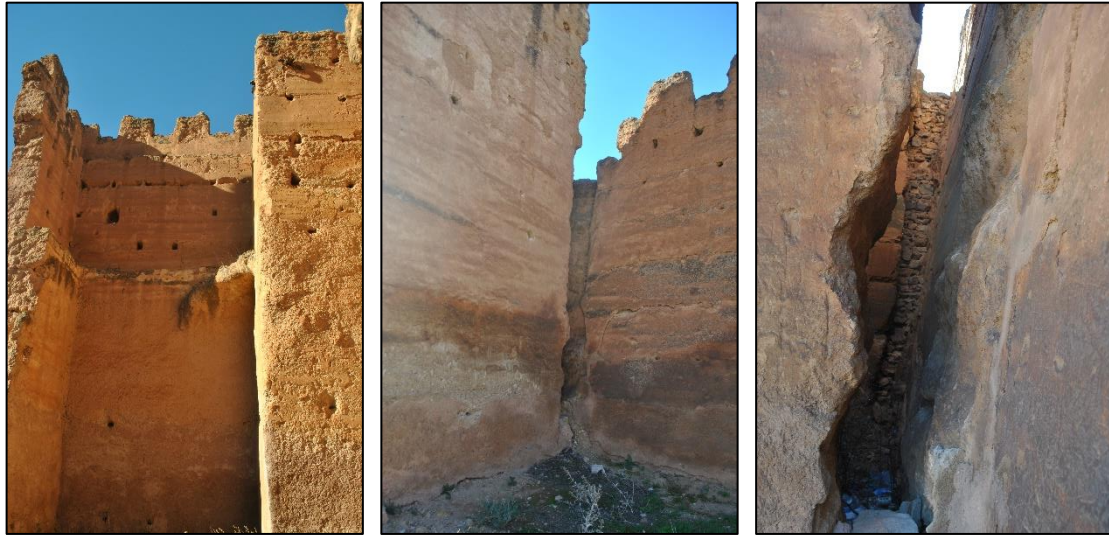
Photo 113. Vue sur l'intérieur de la tour d'angle (à gauche), et de la fracture verticale entre la onzième tour et la courtine. Source auteur du mémoire Mars 2018
