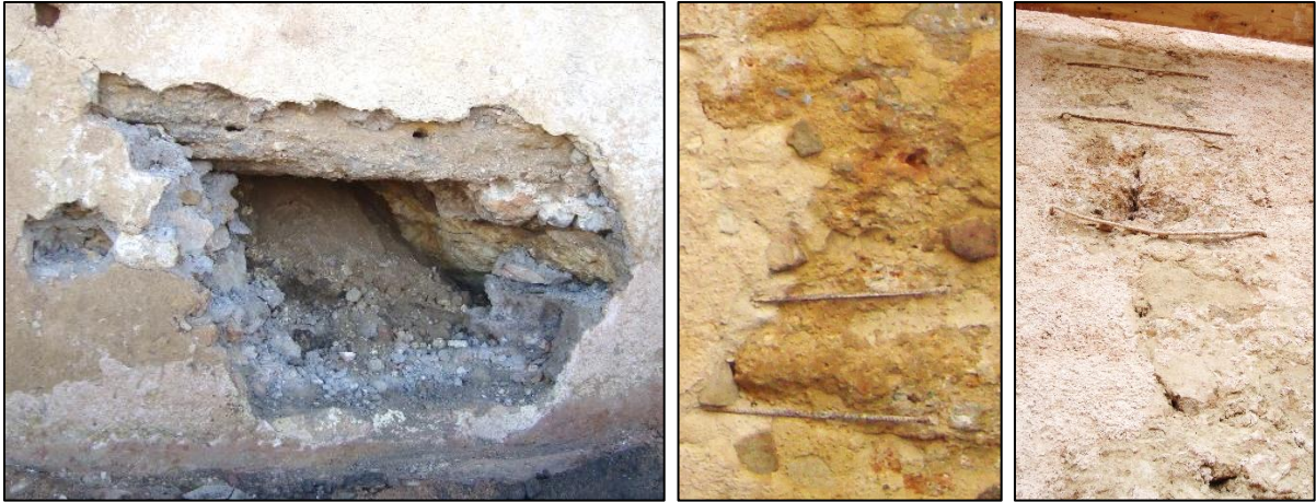
Photo 153. Effondrement d'une partie rajoutée (à gauche), et agrafes métalliques placées (à droite). Source auteur du mémoire Novembre 2010 et Mars 2011
