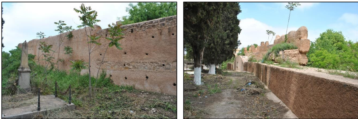
Photo 90. Vues du côté interne du fragment. Source auteur du mémoire Avril 2018
