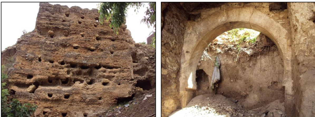
Photo 148. Perte de volume (à gauche) et état de la porte (à droite) après décapage des terres. Source OGEBC
