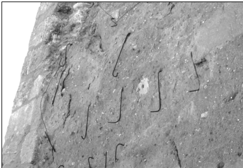
Photo 21. Détachement de la couche de surface. Source Jacinto CANIVELL 224
