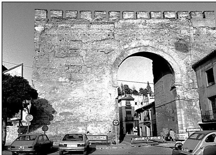
Photo 12. Etat de conservation de la porte avant l'intervention de 1992. Source Antonio ALMAGRO 212
