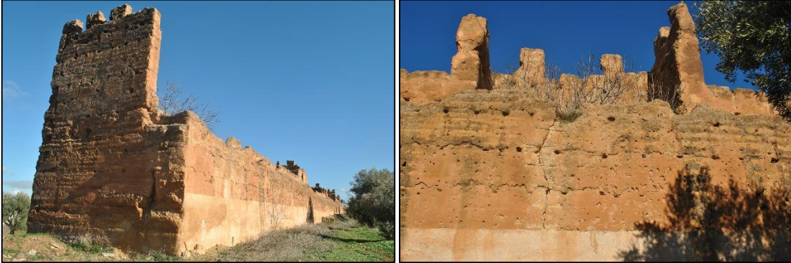
Photo 103. Vue d'ensemble (à gauche), et vue sur une fissure traitée ainsi que la végétation émergeante de l'espace intérieur de la tour. Source auteur du mémoire Mars 2018
