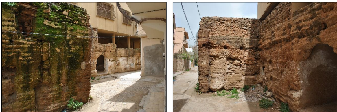
Photo 92. Etat de dégradation avancée du fragment. Source auteur du mémoire Avril 2018
