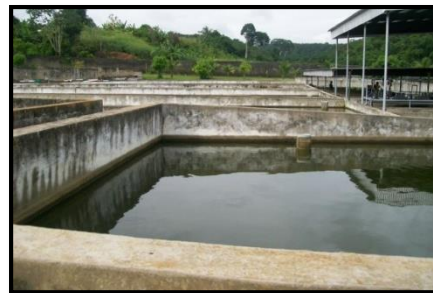
Figure 41 : Bassin en béton
