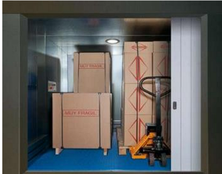
FIGURE 1.3 – Ascenseur de charge [8]
