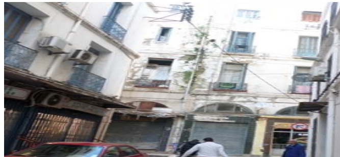
Figure 82: habitat en état vétuste 105
