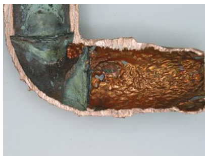
Fig.9 : Corrosion avec érosion
