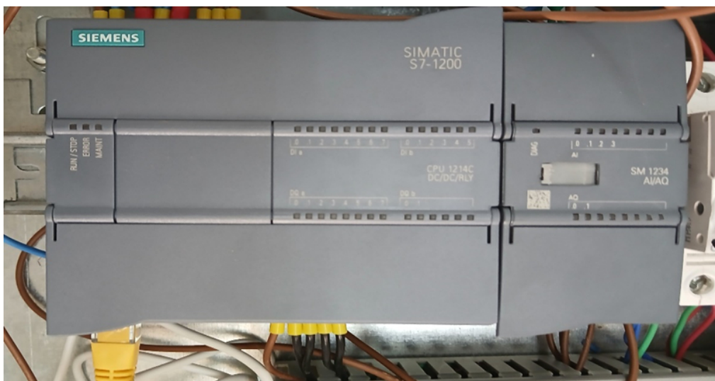
FIG. 4.22 : Automate Siemens câblé dans le coffret, connecté au capteur à ultrasons
