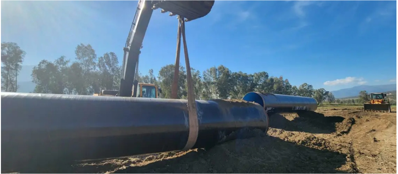
FIG. 1.4 : Conduite principale de transport hydraulique [1]
