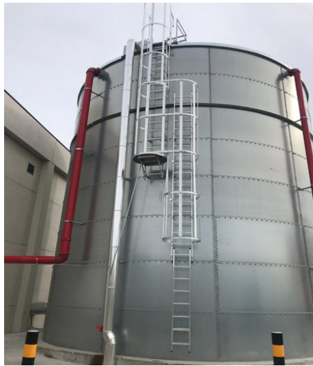
FIG. 1.1 : Réservoir de stockage d'eau [2]
