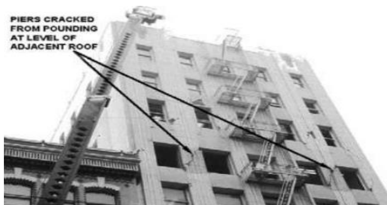
Figure 1.6 : Dommages entre un bâtiment de 10 étages et un autre de 5 étages [59].
