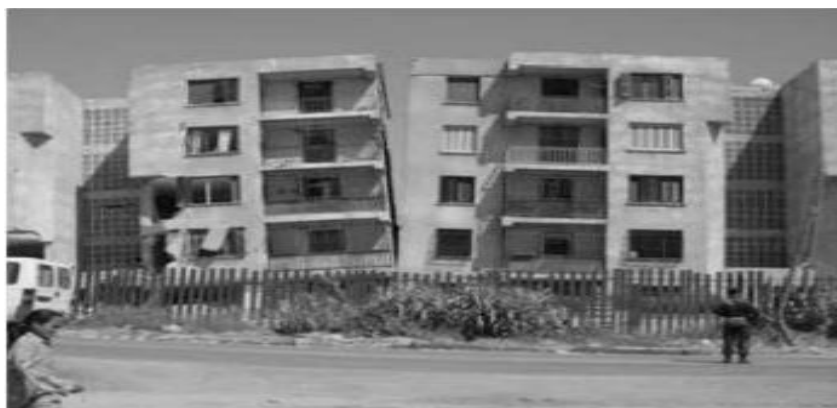
Figure 1.4 : Ouverture entre deux bâtiments (Boumerdes, 2003) [57].
