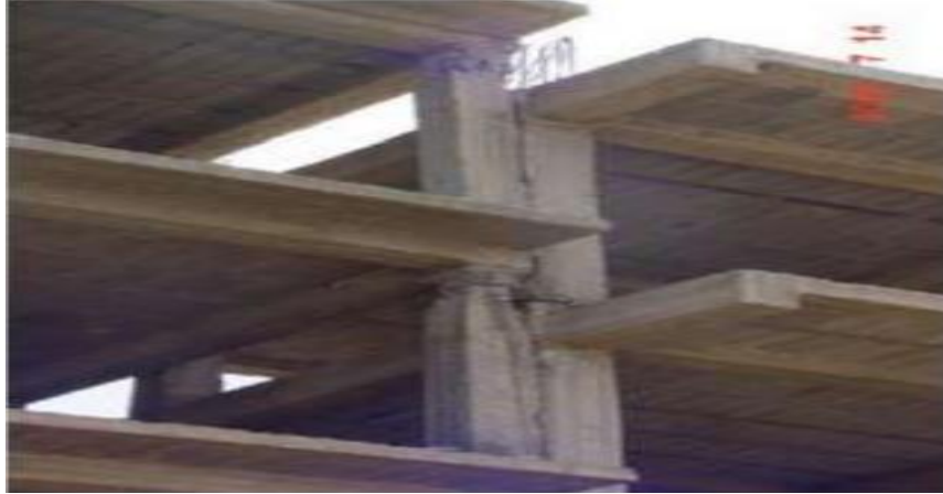
Figure 1.3: Dommages des poteaux dus à l'entrechoquement (le séisme de Boumerdes 21May 2003) [38]
