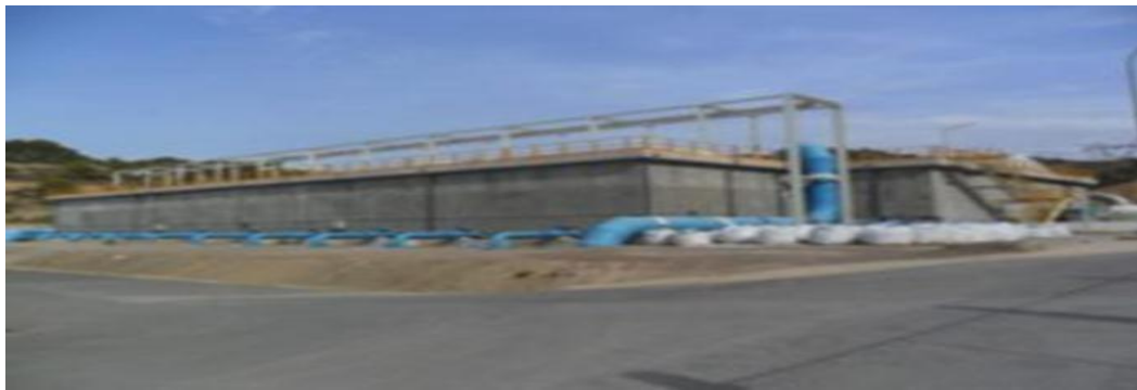
Figure 40 : Photo du réservoir de Re-minéralisation (f)
