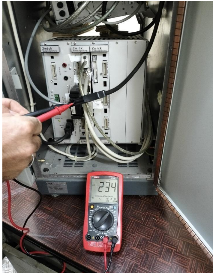
Figure 3.3. Opération de testage du bloc d'alimentation
