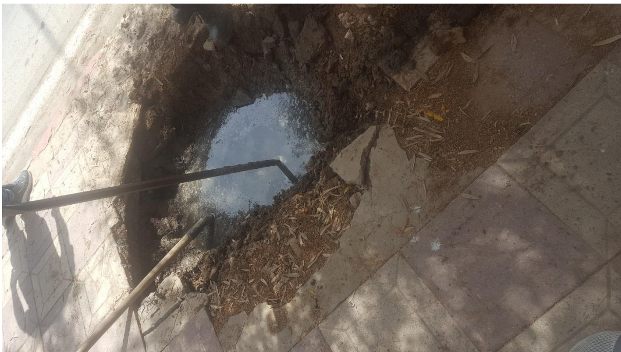
Figure II.7 : Colmatage de tuyau d'égout (15 Mai 2022).
