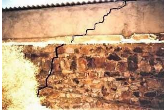
Figure 1. 16 : : Fissuration du mur d'un dépôt de matériaux I (ONEP, Ouarzazate) (Ejjaouani H,2008).
