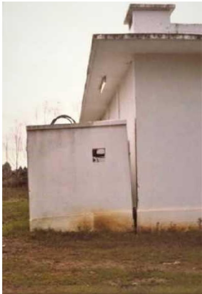
Figure 1.17 : Tassement différentiel du terrain d'une station de pompage (SP13, Garb) (Ejjaaouani H,2008).
