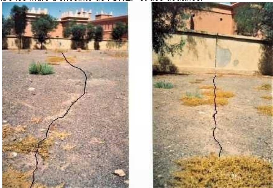
Figure 1. 14 : Migration de l'eau du collecteur d'eaux superficielles de l'ONEP vers le bâtiment des douanes (Ouarzazate) (Ejjaouani H, 2008).
