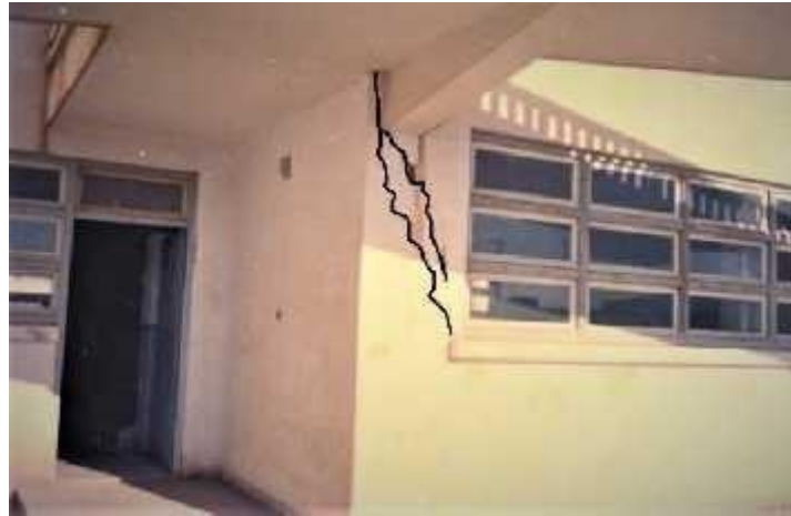
Figure 1. 12 :: dégradations dues au gonflement du sol (Ejjaaouani H,2008).
