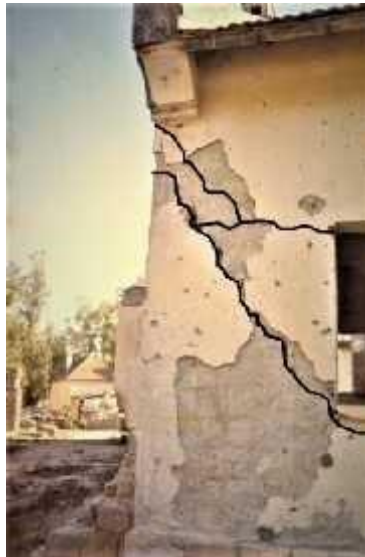
Figure 1. 10 : Rupture du mur d'une école (Berrechid) (Ejjaaouani H, 2008).
