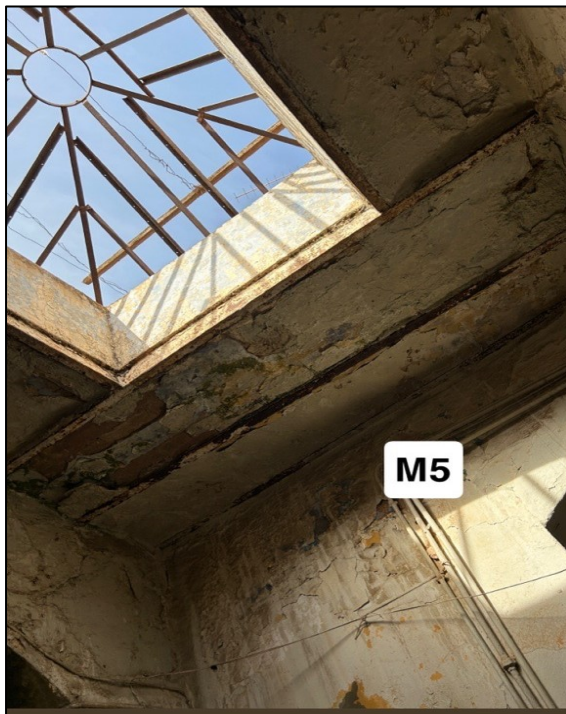
Figure III.12 : Dégradation et humidité au niveau de la dalle autour d'une ouverture zénithale
