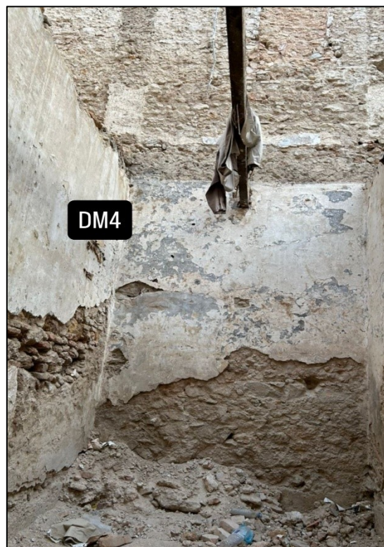
Figure III.23 : Dégradation des enduits et désagrégation des maçonneries
