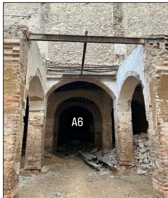
Figure III.19 : Désordres structuraux et déformation des arcs en maçonnerie
