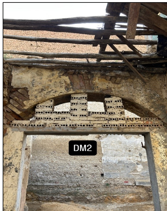
Figure III.21 : dégradation des matériaux au niveau d'une ouverture arquée
