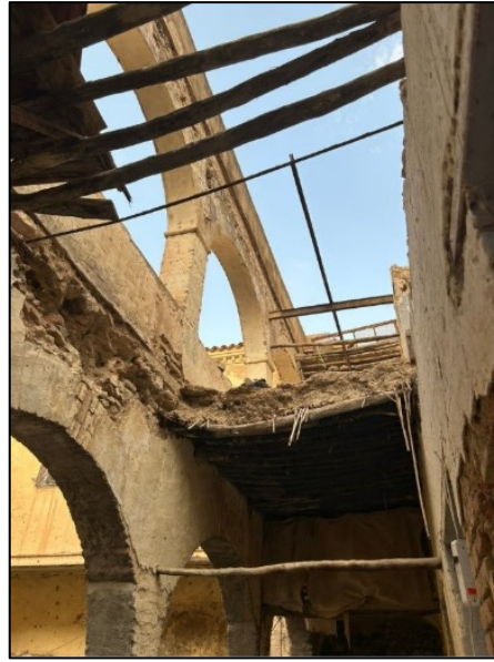
Figure II.17 : Dégradation du plancher
