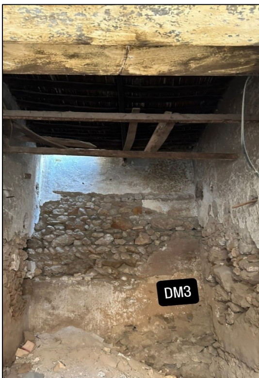
Figure III.22 : Altération des maçonneries et dégradation des surfaces intérieures
