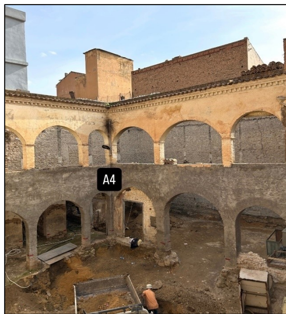
Figure III.17 : Altération des arcs périphériques et dégradation des enduits
