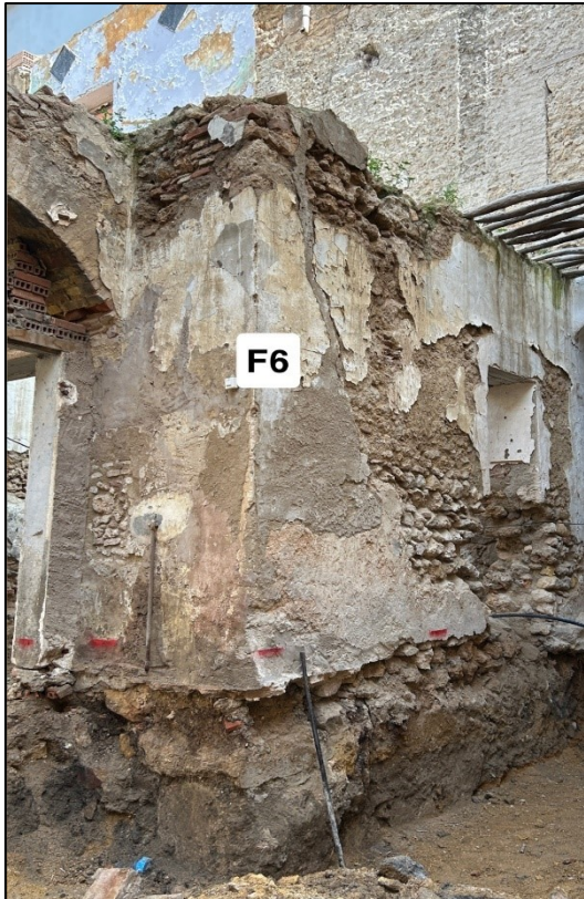
Figure III.5 : Fissuration et dégradation d'un mur porteur avec altération des enduits
