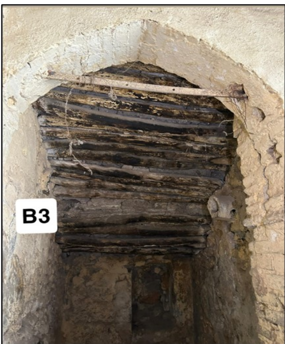
Figure III.33 : Déformation et affaissement du plancher au niveau du passage voûté
