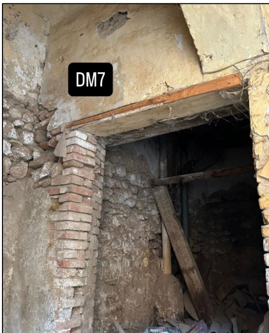
Figure III.26 : Altération des matériaux au niveau d'une ouverture murale
