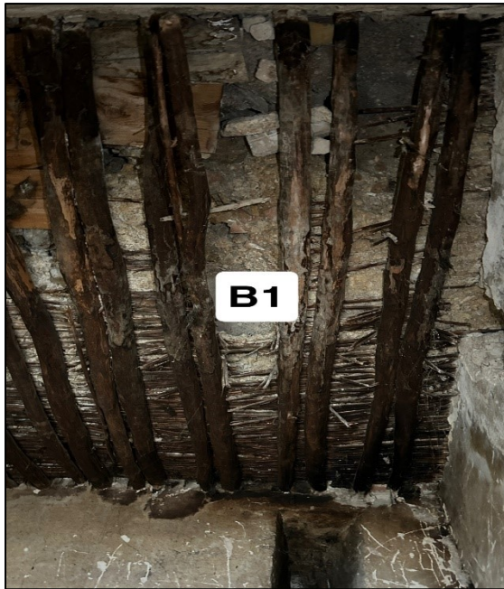
Figure III.30 : Dégradation avancée des solives en bois avec altération et noircissement
