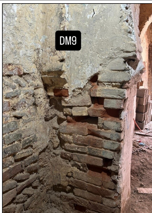
Figure III.28 : Dégradation des briques et détérioration des joints de maçonnerie
