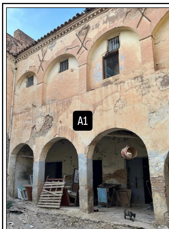
Figure III.14 : Dégradation des arcs et altération des façades intérieures du fondouk
