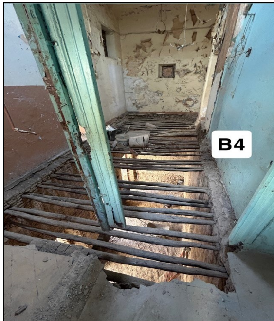
Figure III.34 : Effondrement partiel du plancher en bois (rupture des solives)
