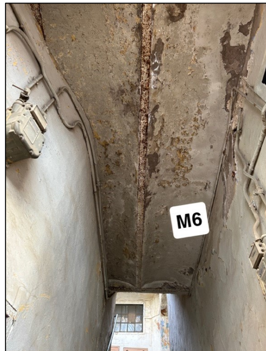
Figure III.13 : Traces d'humidité et altération des surfaces au niveau du plafond et des murs d'un passage
