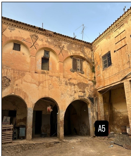
Figure III.18 : Dégradation généralisée des arcs et des maçonneries porteuses
