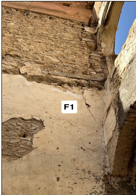
Figure III.1 : Fissuration au niveau d'un angle de mur porteur
