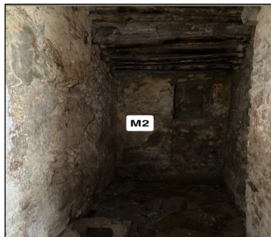
Figure III.9 : Humidité généralisée dans un espace intérieur confiné
