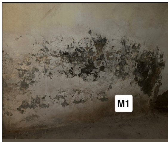
Figure III.8 : Présence de moisissures et traces d'humidité sur un mur intérieur
