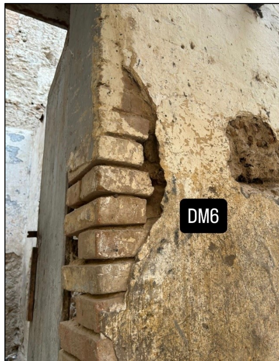
Figure III.25 : Dégradation localisée d'un angle maçonné en brique
