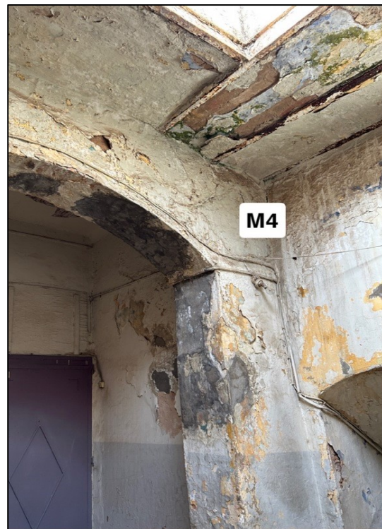
Figure III.11 : Altération des enduits et traces d'humidité au niveau d'un arc et d'un mur intérieur
