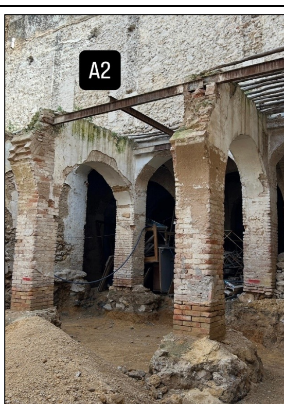
Figure III.15 : Désordres structuraux affectant les arcs et les piliers en maçonnerie
