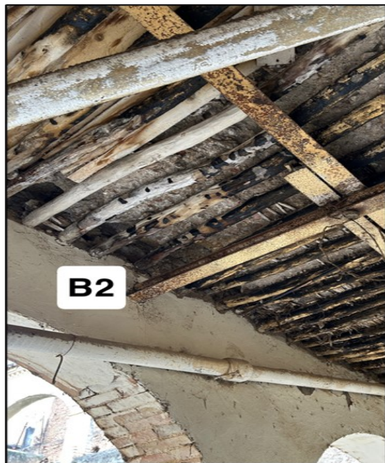
Figure III.32 : Dégradation des éléments en bois avec corrosion des pièces métalliques associés
