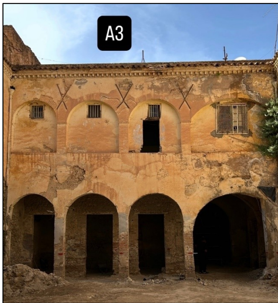
Figure III.16 : Déformation et dégradation des galeries voûtées du niveau supérieur
