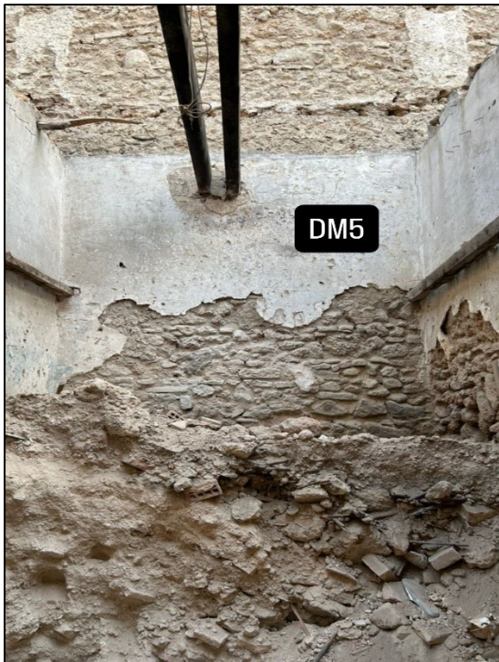
Figure III.24 : Effritement des matériaux et perte de cohésion des murs
