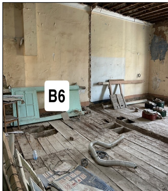
Figure III.37 : Dégradation du platelage et instabilité du plancher supérieur
