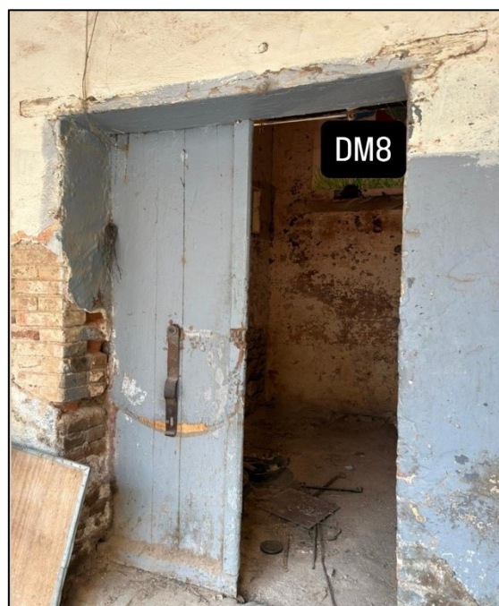
Figure III.27 : Dégradation des encadrements et détérioration des revêtements
