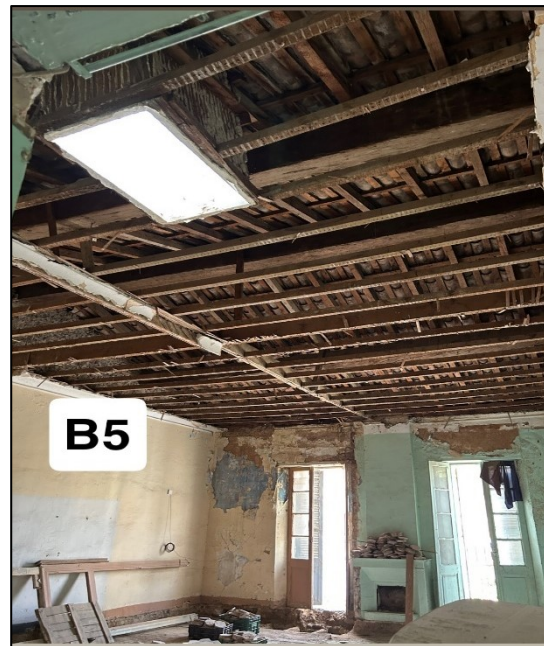
Figure III.35 : Fléchissement du solivage et déformation du plafond
