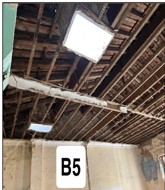
Figure III.36 : Altération du plafond et dégradation des éléments de plancher
