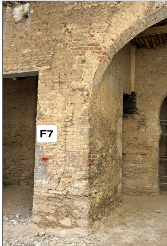
Figure III.6 : Fissuration affectant un poteau en maçonnerie de brique pleine
