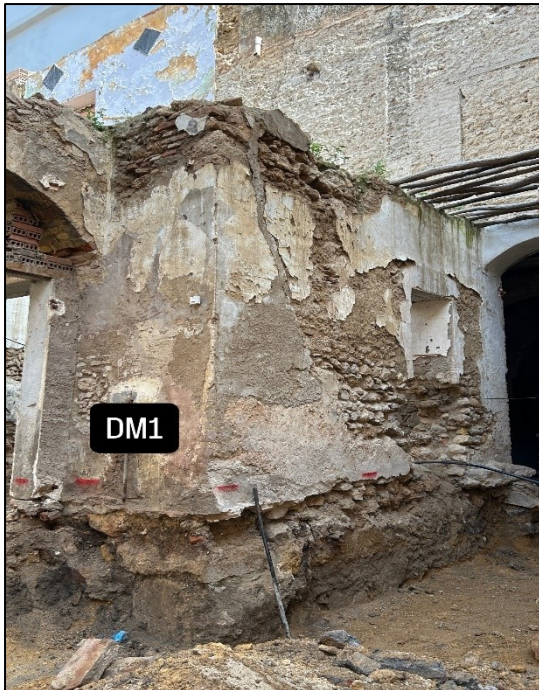
Figure III.20 : Dégradation avancée d'un mur en maçonnerie et perte de revêtement
