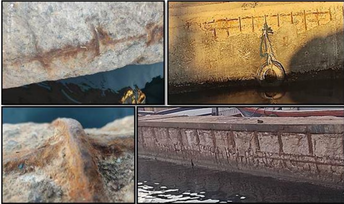
Figure I.1 : Eclatement de l'enrobage des armatures du port de Béni-Saf (Harouat Amina, 09/2021).
