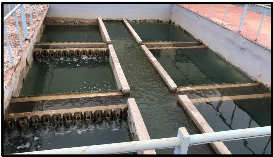
Figure.16 : Bassin de Filtration.
