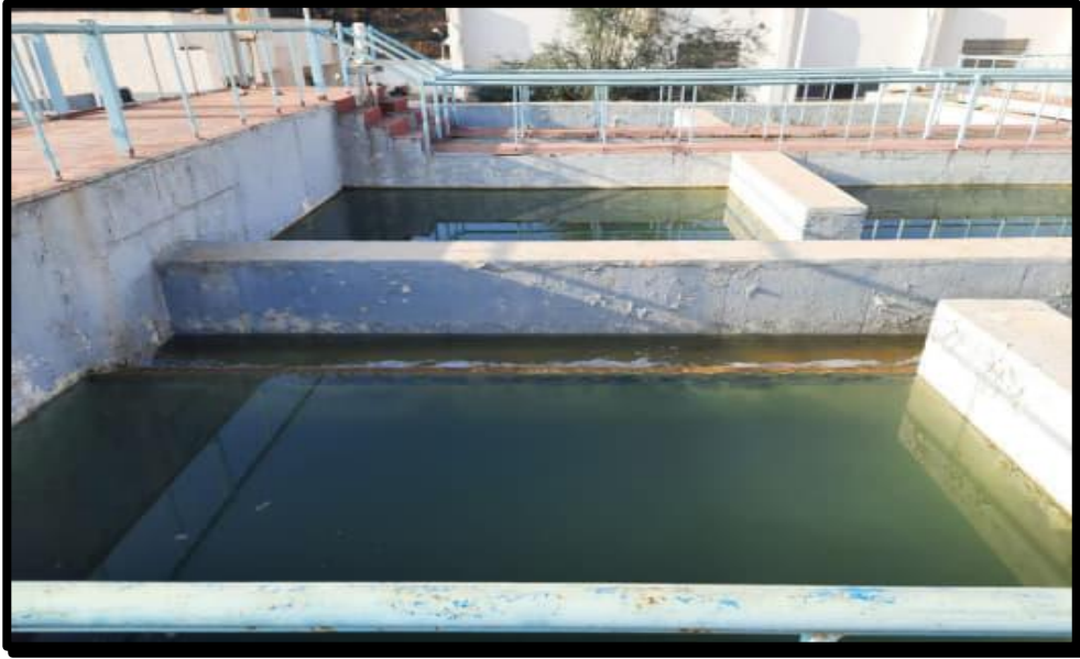
Figure.15 : Bassin de décantation
