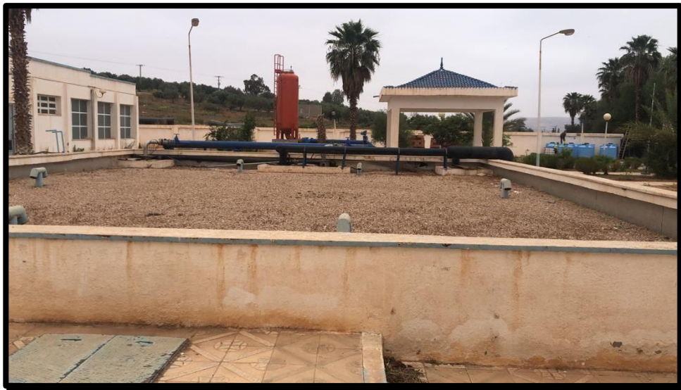
Figure.18 : Réservoir de stockage.
