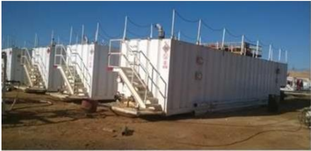
Fig. 11- Bacs de décantation d'UBD.
