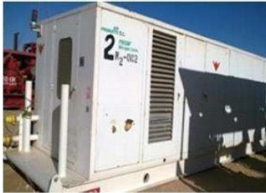
Fig. 5- Unité de production nitrogène.
