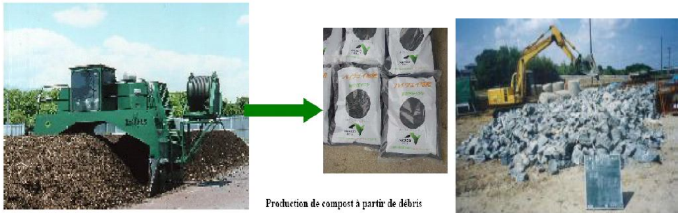
Fig.4-50 Destruction de déchets de ciment jusqu'à ce qu'ils soient assez petits pour être recyclés.
