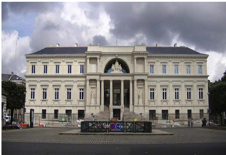
la reconversion en cours de l'ancien palais de justice de Nantes en hôtel Radisson Blu de 142 clés (ouverture prévue fin 2012)
