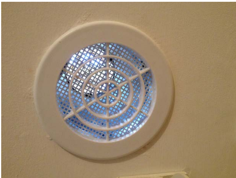
Figure132 : une gaine d'aérations source ; http://www.bricolerenove.fr
