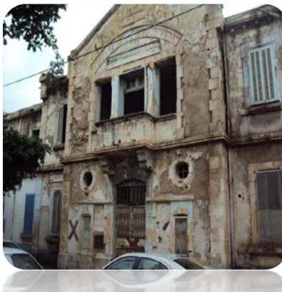
Mauvaise état source : auteur
