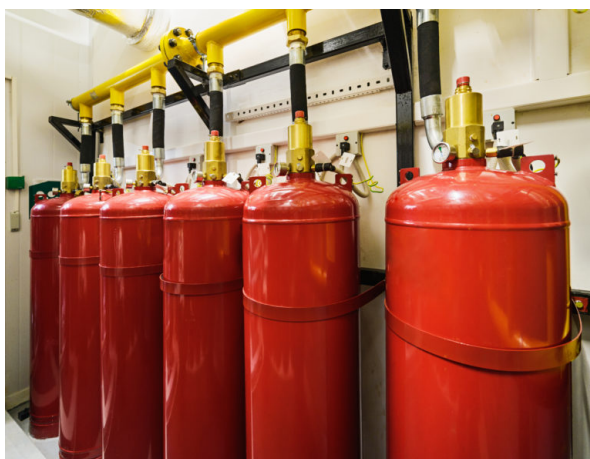
FIGURE 1.9 – installation d'extinction à gaz [9]
