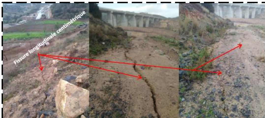
Figure III-4 Début de fissuration au niveau de tête et le long du pied de talus amont.
