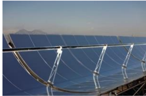
Figure I. 6 Les centrales à capteurs Cylindro - parabolique
