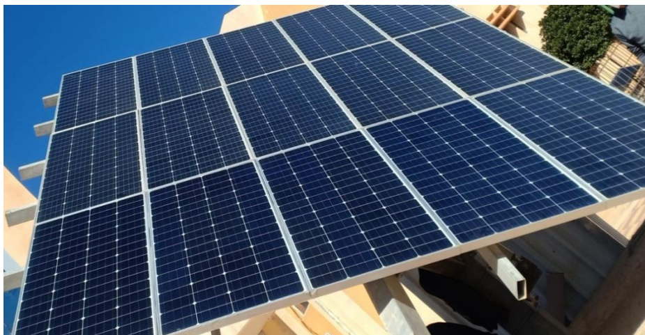
Figure I. 3 Structure d'un panneau photovoltaïque à L'université Abou Bekr Belkaid Tlemcen
