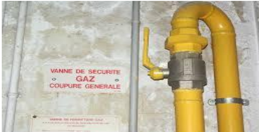
Figure I.11 : Vanne de sécurité gaz (organe de coupure générale OCG)
