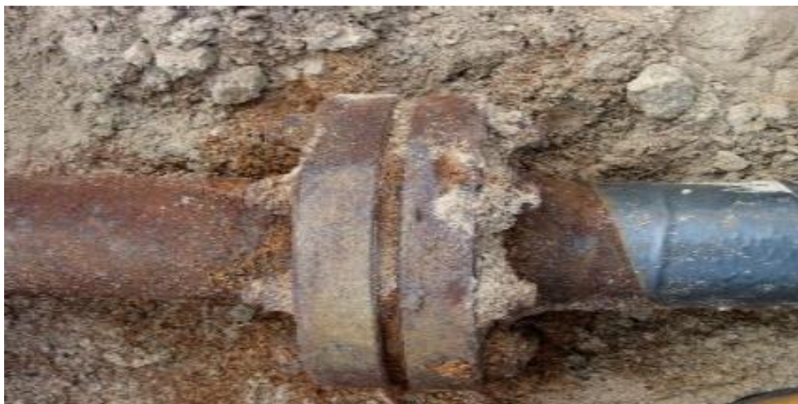
Figure II.11 : Corrosion par l'effet de Couples galvaniques
