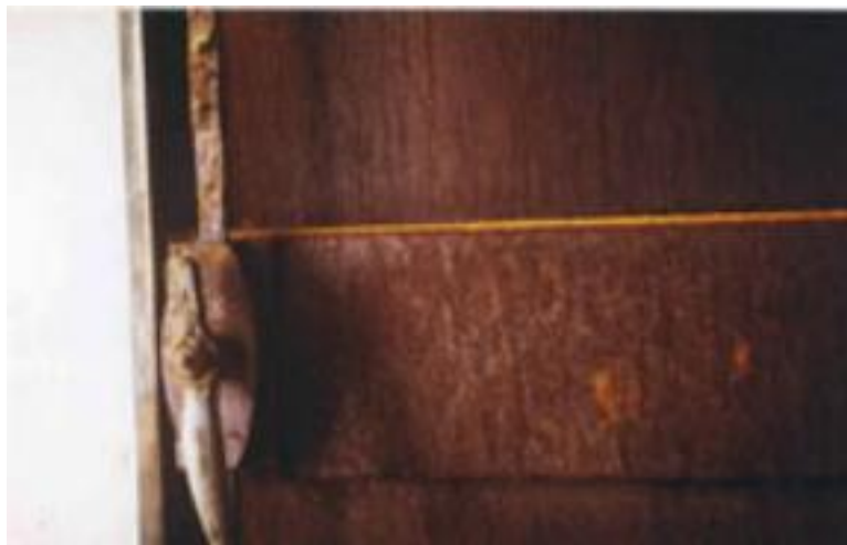
Figure II.3 : Corrosion d'une porte en acier inoxydable ferritique dans une atmosphère soufrée
