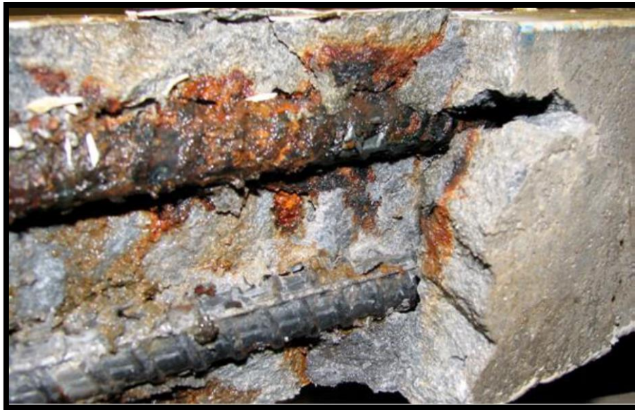
Figure I.5 : Corrosion des armatures
