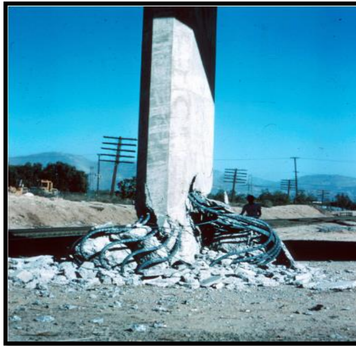
Figure II.2 : Un support en acier armé du passage supérieur des autoroutes a été endommagé lors du San Fernando en 1971 [23]
