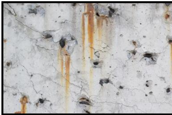
Figure I.6 : Corrosion par piqûres liées aux chlorures [5]
