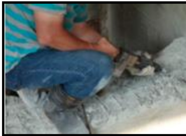
Figure II.6 : Enlèvement du béton de couverture et rugosité de la surface (Saim Raza. Muhammad K. I. Khan .Scott J. Menegon . Hing-Ho Tsang . and John L. Wilson, 2019)
