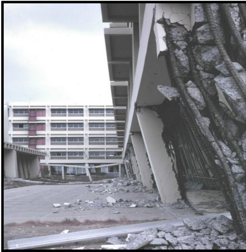
Figure II.1 : Dommages à l'Olive View Médical Center (9 février 1971) [22]
