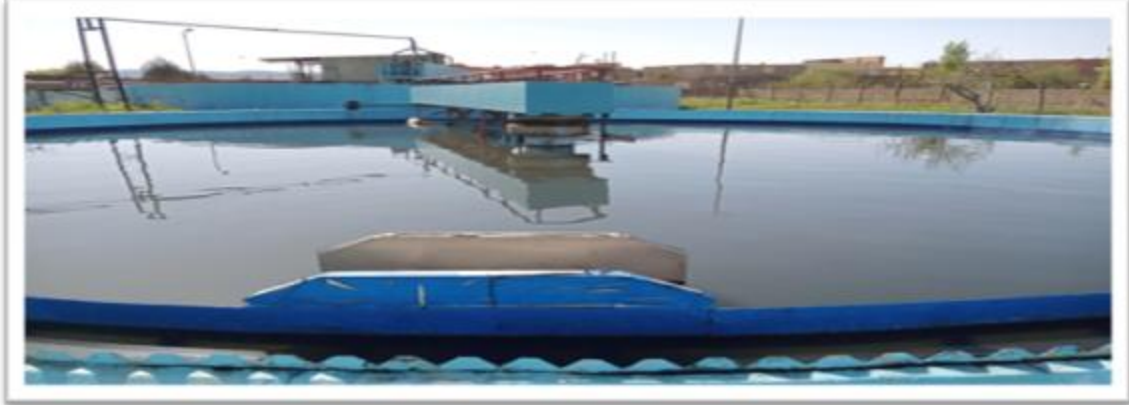
Figure. II .6: Photo du bassin de clarification finale (1) et (2).
