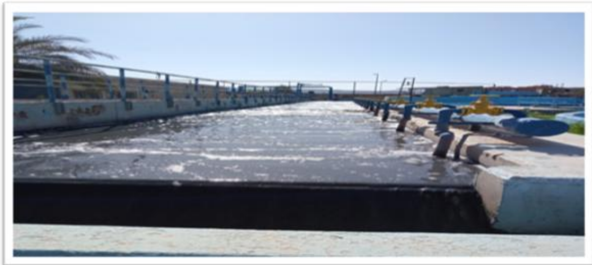
Figure. II. 5: Photo du bassin de traitements biologique (traitement aérobie)
