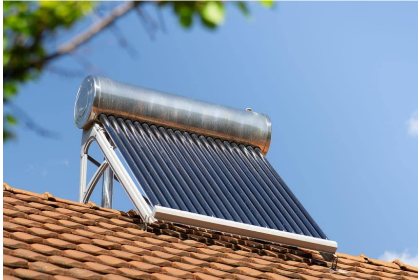
Figure I. 17 : Capteurs solaires thermiques
