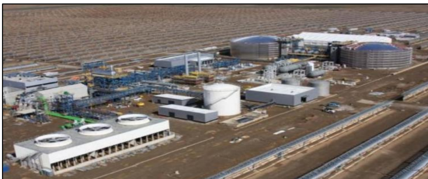
Figure 3. 12 : Photographie de la centrale ANDASOL les cuves de stockage sont visibles en haut à droite
