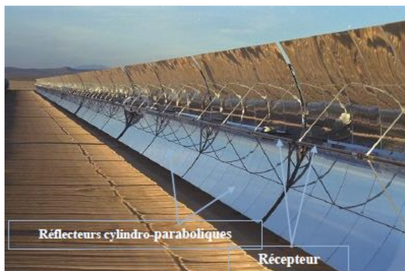
Figure 18. Vue d'une ligne de miroirs
