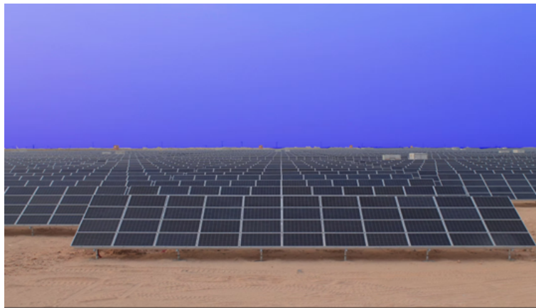
FIGURE III.1 – parc des panneaux solaire au cite d'Adrar
