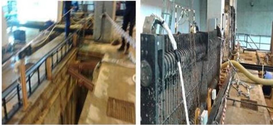
Figure IV. 6 : Le dégrillage pour éliminer les plus gros déchets. [42]
