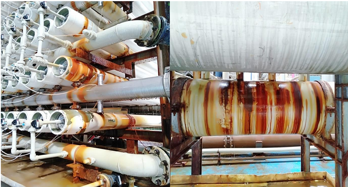
Figure V. 1: Corrosion localisée sur une conduite d'osmose inverse (OI), 26 mars 2025.
