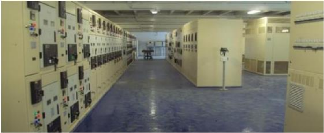
Figure IV. 31 : Salle d'électricité de la SDEM de Béni Saf. [39]
