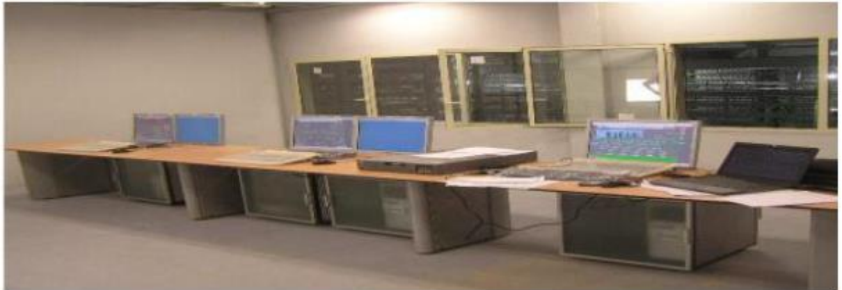
Figure IV. 30 : la salle de contrôle de la SDEM de Béni Saf [39]
