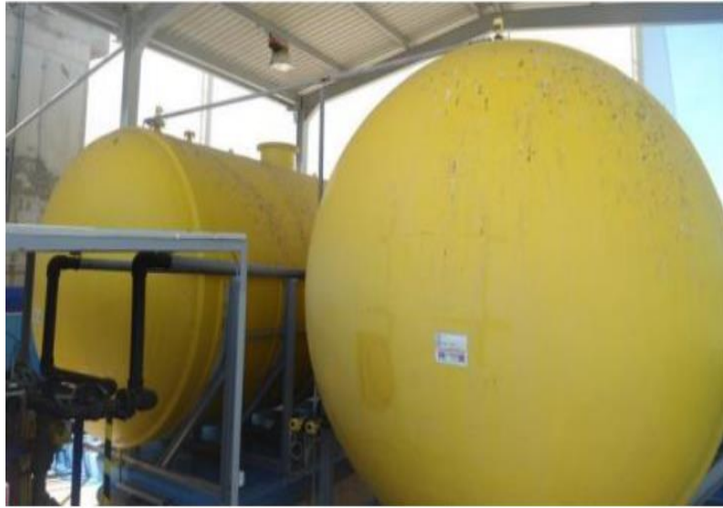
Figure IV. 10 : Réservoir de stockage d’Hypochlorite de sodium. [42]
