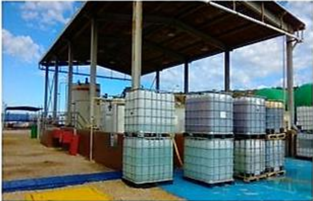
Figure IV. 11 : Bâtiment de dosage chimique, 17 mars 2025.
