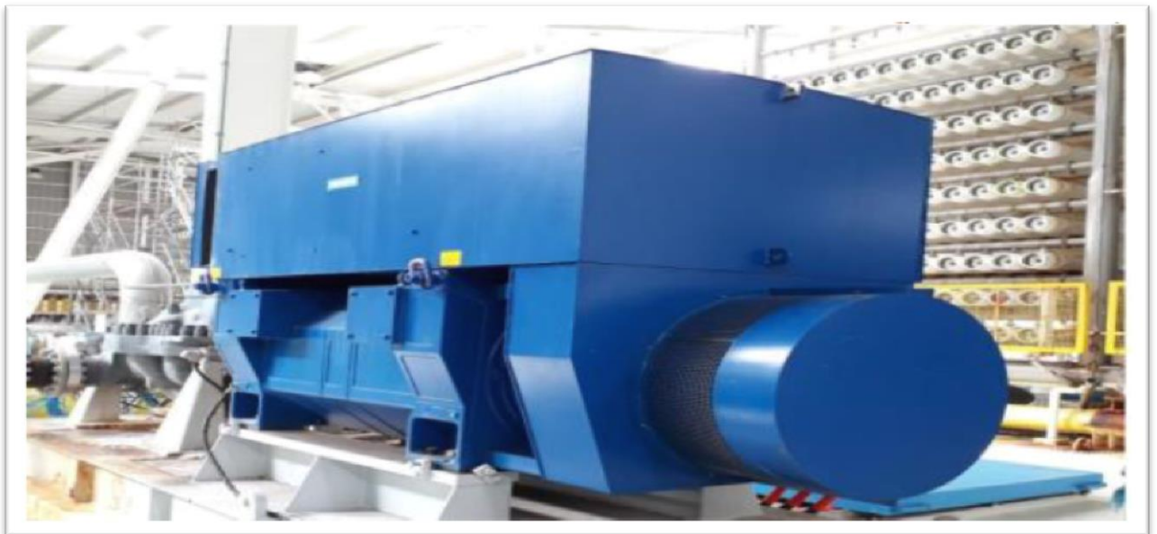
Figure IV. 21 : Pompe de recirculation, 19 mars 2025.
